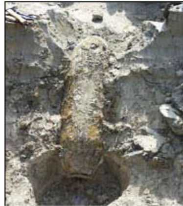
Abb. 1. Fliegerbombe, angetroffen bei Bauarbeiten in der Nähe einer Tankstelle
