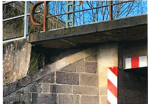
Abbildung 11: Spalt unterhalb der Betondecke der Brücke
