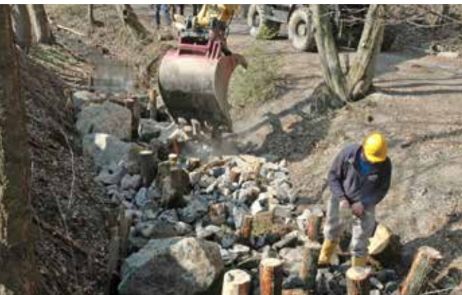
Abb. 96: Mit dem Einbringen von standortfremden Gesteinsmaterial in ein Bachbett können im Rahmen einer Renaturierung invasive Arten eingeschleppt werden. Foto: RP Gießen
