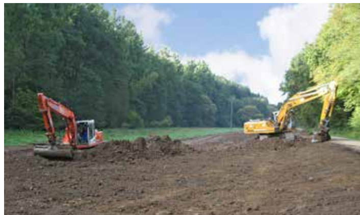
Abb. 97: Durch eine Baumaßnahme freigelegter Boden bietet invasiven Pflanzenarten günstige Ansiedlungsmöglichkeiten. Foto: RP Gießen
